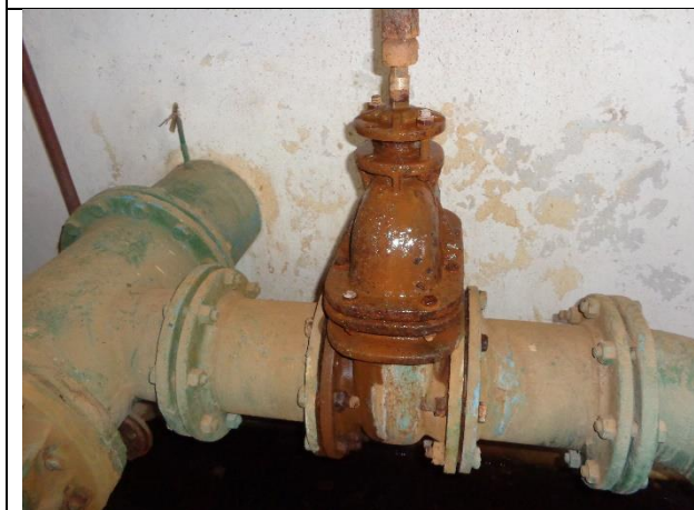
Foto 14. ETA Peixoto Filho - Vazamento nos registros e descarga de filtros
