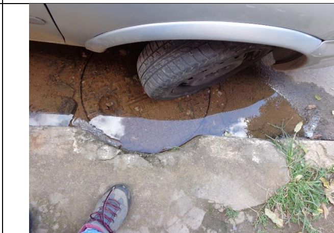
Foto 4. Vazamento na Rua Senador Levindo Coelho, bairro Centro, durante a semana de fiscalização.
