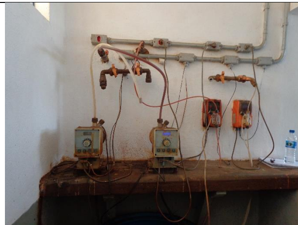
Foto 40. Bombas dosadoras sem identificação do produto químico em uso.
