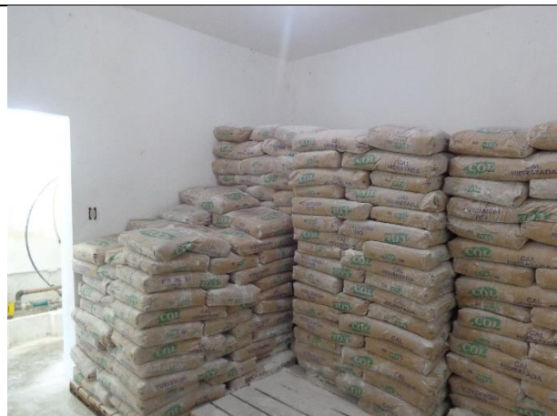
Foto 35 – ETA Miragaia - Produtos químicos encostados nas paredes
