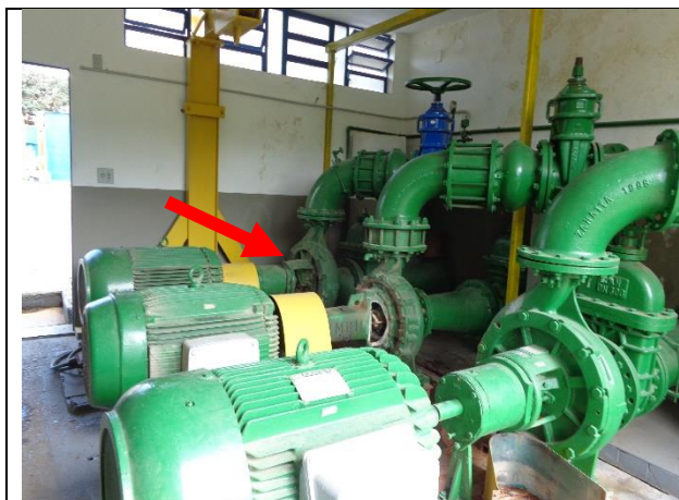
Foto 12. EEAT 2 da ETA Miragaia - Vazamento nos registros e nos CMB
