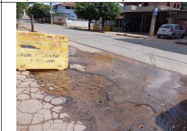
Foto 6. Vazamento na Rua Senador Levindo Coelho, bairro Centro, durante a semana de fiscalização.
