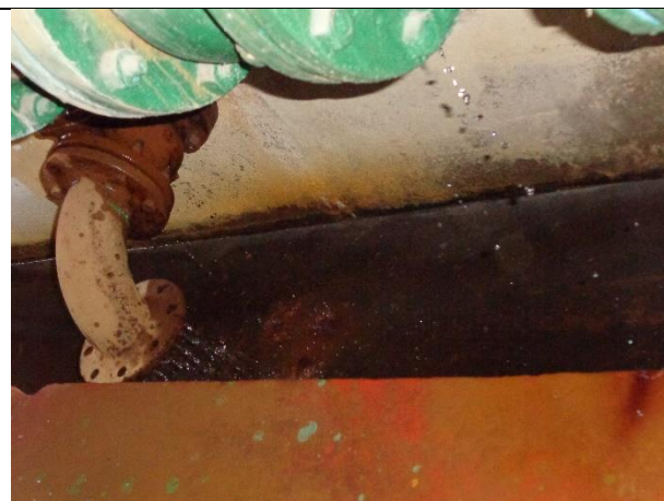
Foto 15. ETA Peixoto Filho - Vazamento nos registros e descarga de filtros
