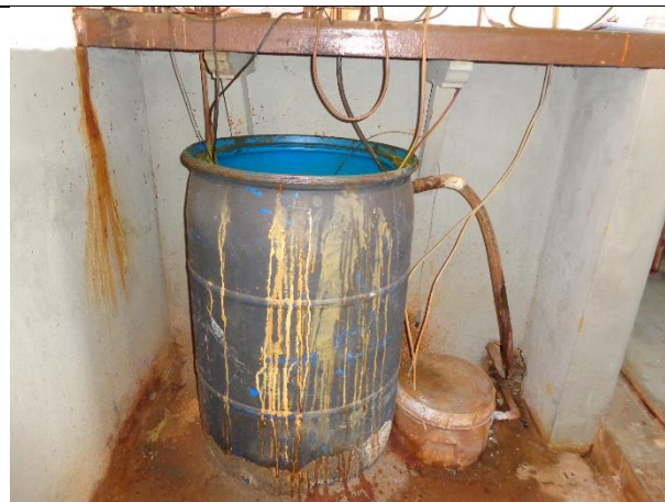
Foto 38 – ETA Miragaia - Produtos químicos sem identificação
