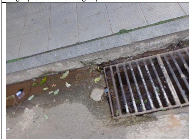
Foto 5. Vazamento na Rua Senador Levindo Coelho, bairro Centro, durante a semana de fiscalização.
