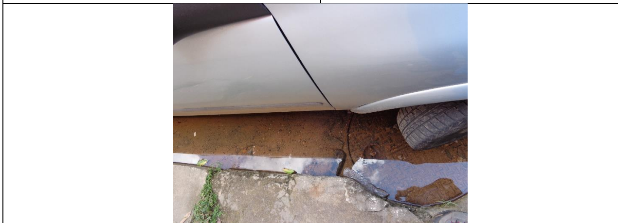
Foto 16. Rede de distribuição de água – Registro de manobra localizado na Rua Senador Levindo Coelho, próximo ao nº 150.
