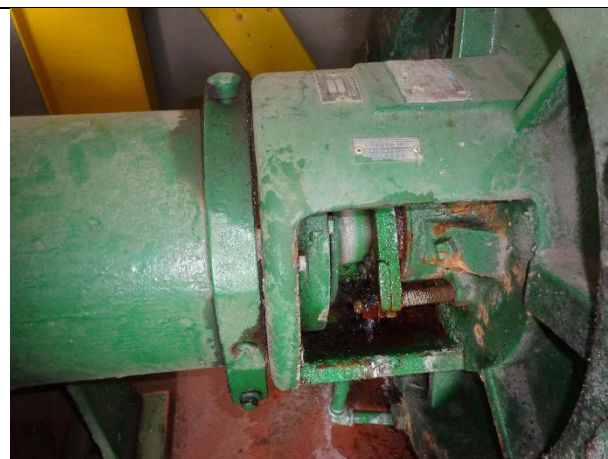
Foto 13. EEAT 2 da ETA Miragaia - Vazamento nos registros e nos CMB
