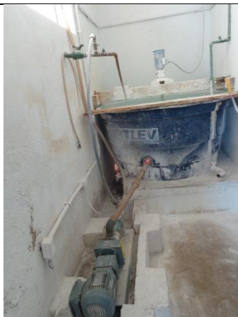
Foto 37 – ETA Miragaia - Produtos químicos sem identificação
