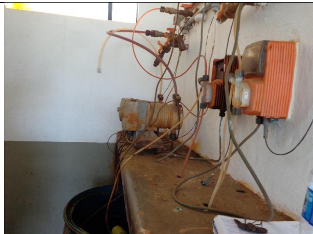
Foto 39. Bombas dosadoras sem identificação do produto químico em uso.
